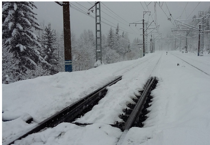
Работа системы электрообогрева на ст. Нанхчул Красноярской железной дороги
